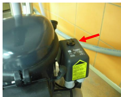
Photo 7 : Marche / arrêt du compresseur
