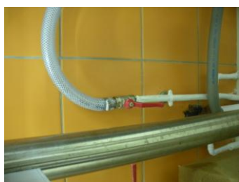
Photo 6 : arrivée d'eau du groupe de chauffe
