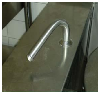
Photo 3 : robinet d'alimentation en position OFF
