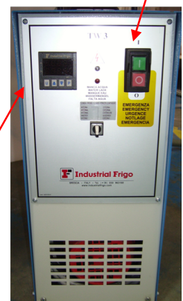
Photo 9 : groupe de chauffe
